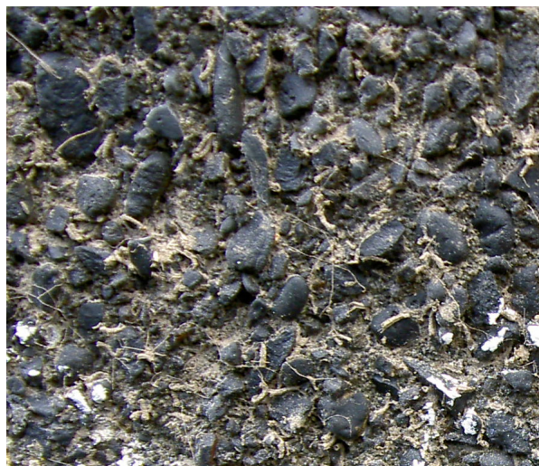
写真1 水路コンクリートの表面劣化
