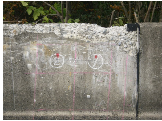
写真-2 凍害劣化状況
