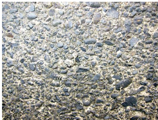
写真-1 水路構造物の表面劣化
